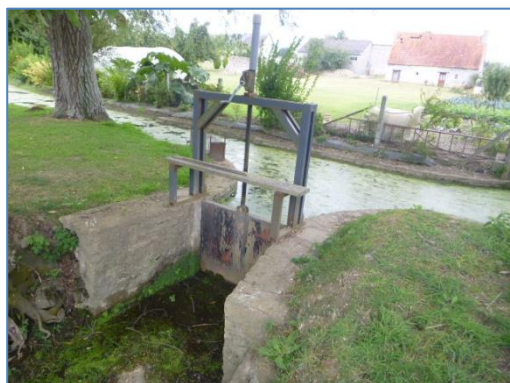
Vue de la vanne de décharge amont.
